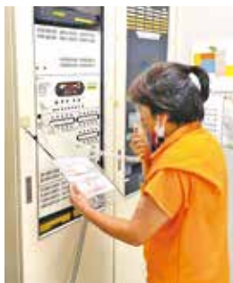
緊急放送で避難を誘導する職員
